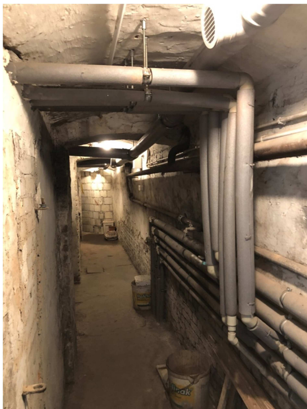
Instalacje w korytarzu piwnicy.
