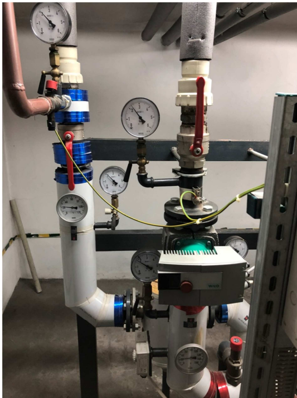
Instalacje w pomieszczeniu węzła cieplnego.
